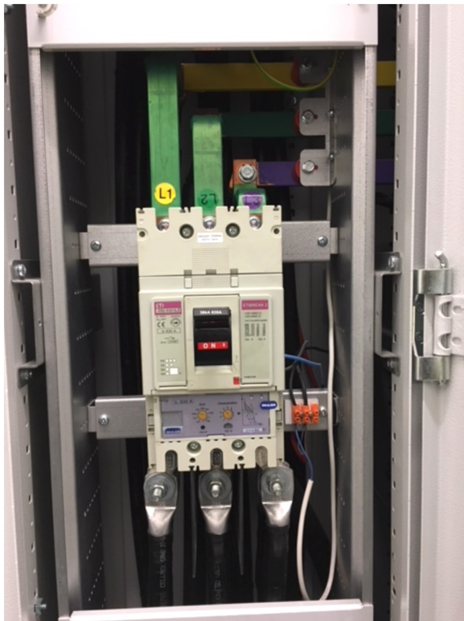
Fot. 1. Wyłącznik główny, pod którym należy założyć przekładniki prądowe 600/5A do kontroli obciążenia transformatora głównego
