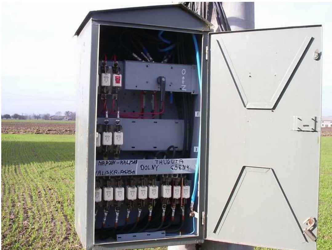
Rys. 3.40. Widok rozdzielnic w stacji STSR
