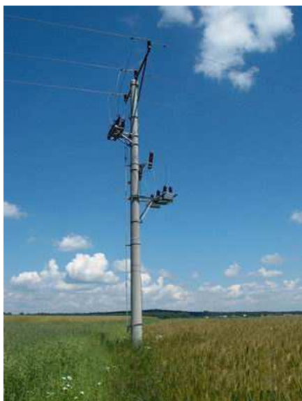
Fot. 3. Napowietrzna, nasłupowa bateria kondensatorów 15kV (ELMA energia)
