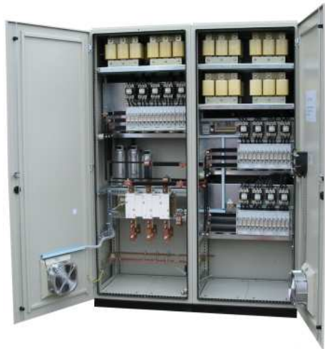
Automatycznie regulowana bateria KMD720R 400V (prod. ELMA energia) z dławikami (filtry odstrojone) f_r = 189\text{Hz} .
