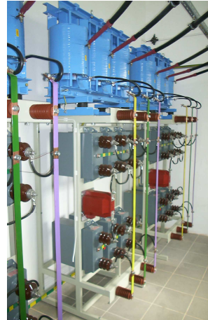
Bateria kondensatorów BSDR średnich napięć 6,3kV. Produkcja firmy ELMA energia w Hucie Głogów S.A.
