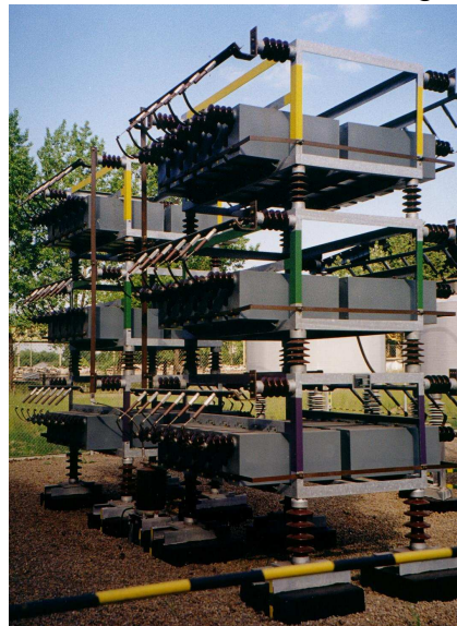
Bateria wysokich napięć 35MVar/42kV. Realizacja firmy ELMA energia w Hucie Ostrowiec S.A.
