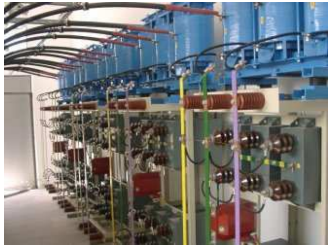
Filtry odstrojone średnich napięć 6,3kV ( f_r = 189\text{Hz} ) instalacji kompensacyjnej w Hucie Miedzi Głogów S.A. (realizacja ELMA energia)
