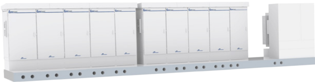
Zdjęcie: Dwa Inwertery Freesun HEC zainstalowane na 10m podstawie betonowej wraz z transformatorem poduszkowym.
